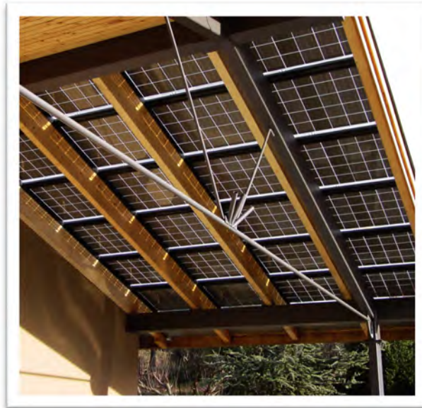
Fig.:Installation Marxiquanes 66500. Enersun. Système SolarStyl® .
