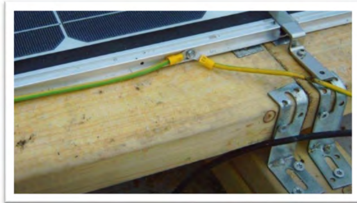
Fig. : Connexion à la terre déficiente des cadres en aluminium. On note que le câble électrique a été coupé probablement par le frottement sur les équerres en acier.
