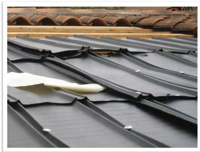
Fig. : l'étanchéité plastique a été arrachée par les modules photovoltaïques
