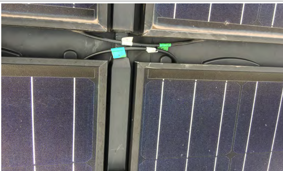
Les cables des deux strings (haut et bas) ne cheminent pas avec les cables retour de polarité. Le conducteur d'équipotentialité est distant. Ceci entraine la présence de boucles inductives.
